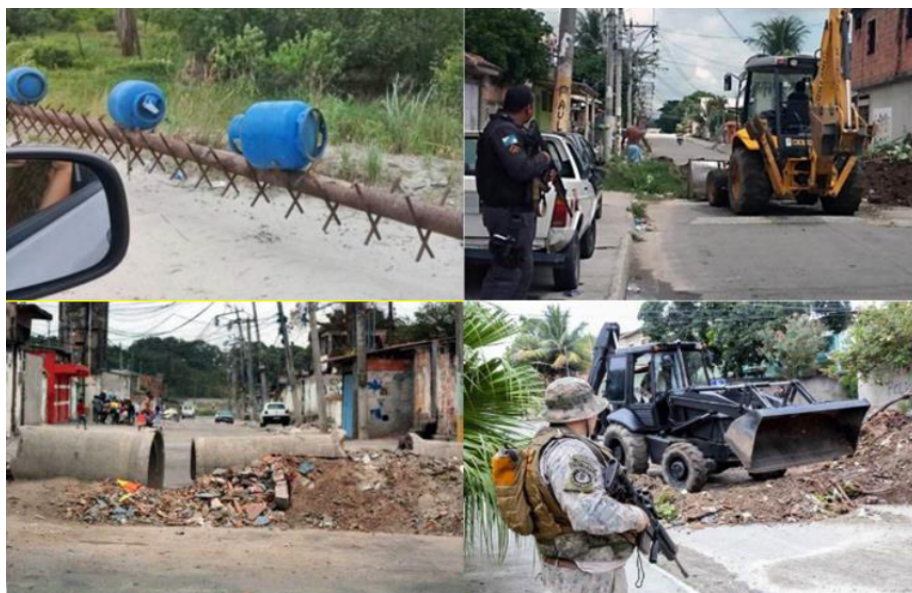
Figura 35 – Barreiras impedindo o acesso a ASROs na região metropolitana do Rio de Janeiro.
