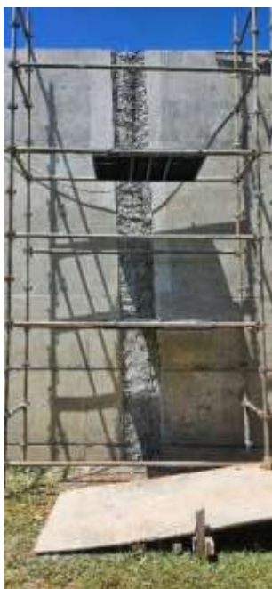
Figura 13: Abertura de trecho com trinca.
