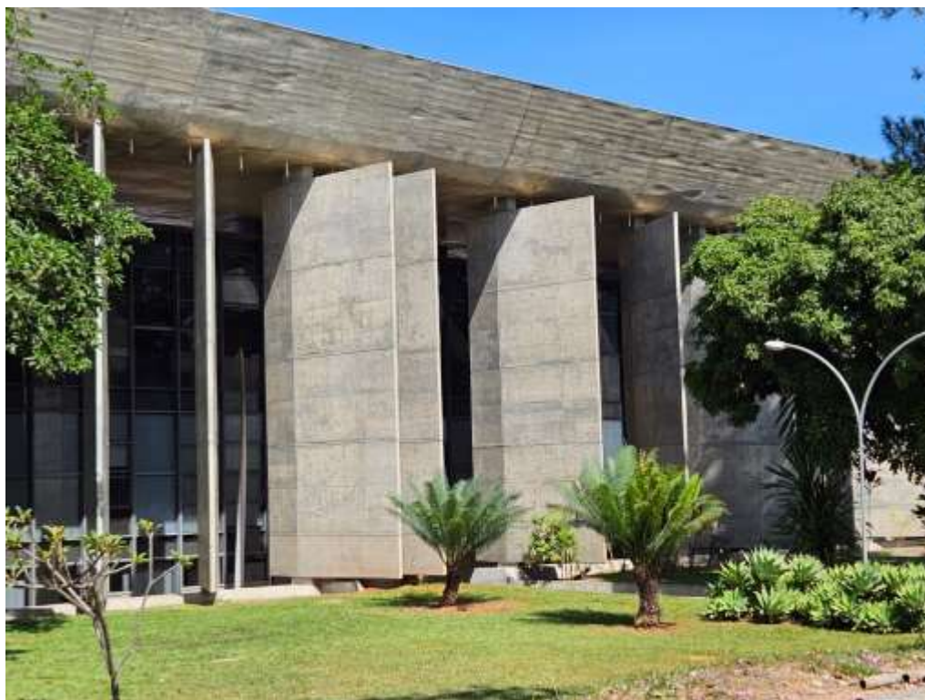
Figura 20: Superfícies de concreto aparente da Biblioteca Central, marcadas pelo desenho original das formas, mesmo após recuperação e tratamento.
