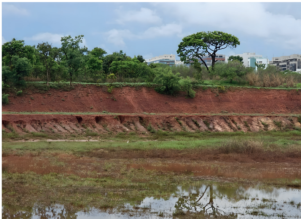
Figura 4 – Bacia Noroeste: processo erosivo dos taludes em uma bacia de retenção no Distrito Federal.
