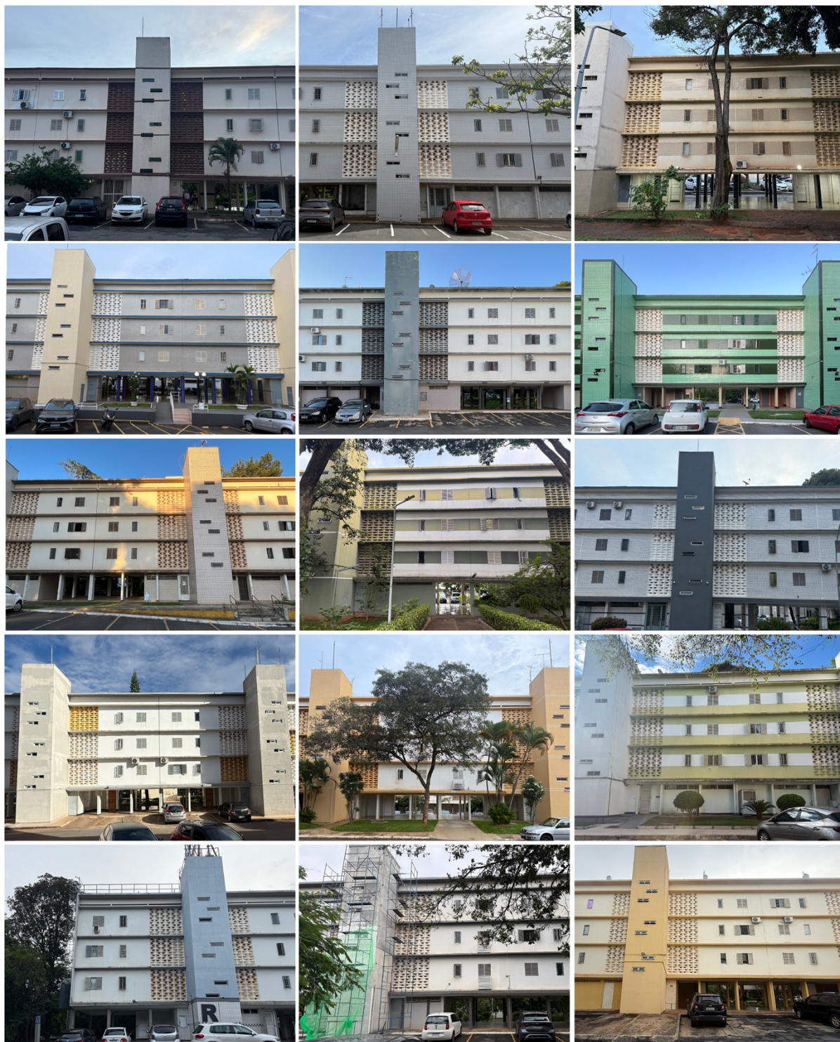
Figura 79 – Estado da fachada posterior de diferentes exemplares do R2 pela Asa Sul. Fotos de autoria própria, tiradas entre 2023 e 2026.
