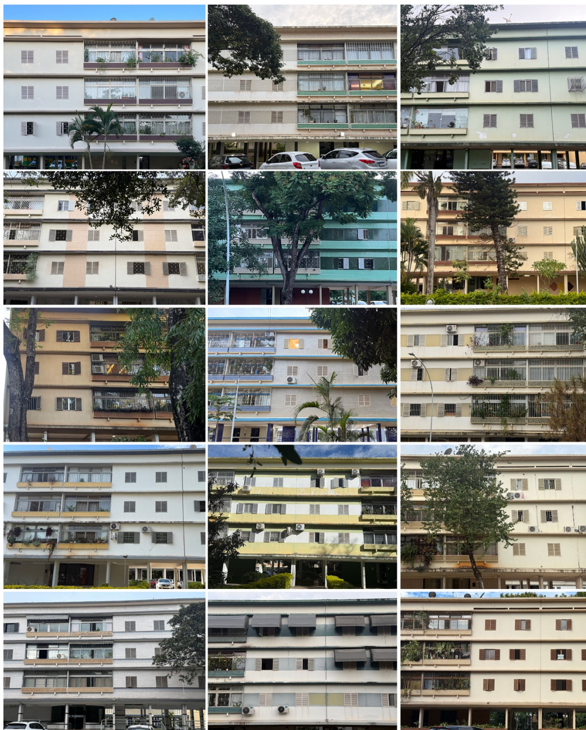
Figura 76 – Estado da fachada principal de diferentes exemplares do R2 pela Asa Sul. Fotos de autoria própria, tiradas entre 2023 e 2026.
