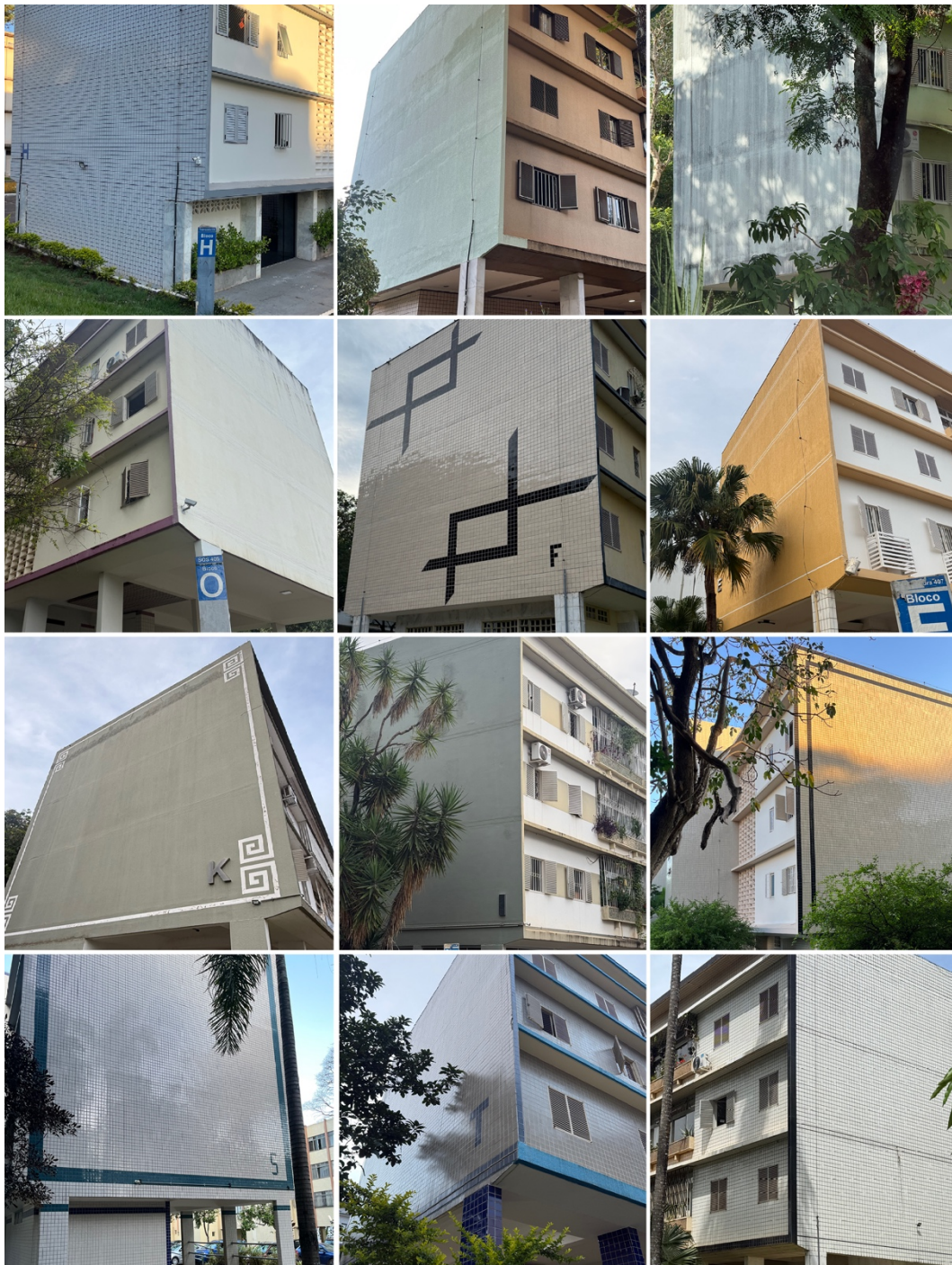
Figura 78 – Estado de empenas de diferentes exemplares do R2 pela Asa Sul. Fotos de autoria própria, tiradas entre 2023 e 2026.
