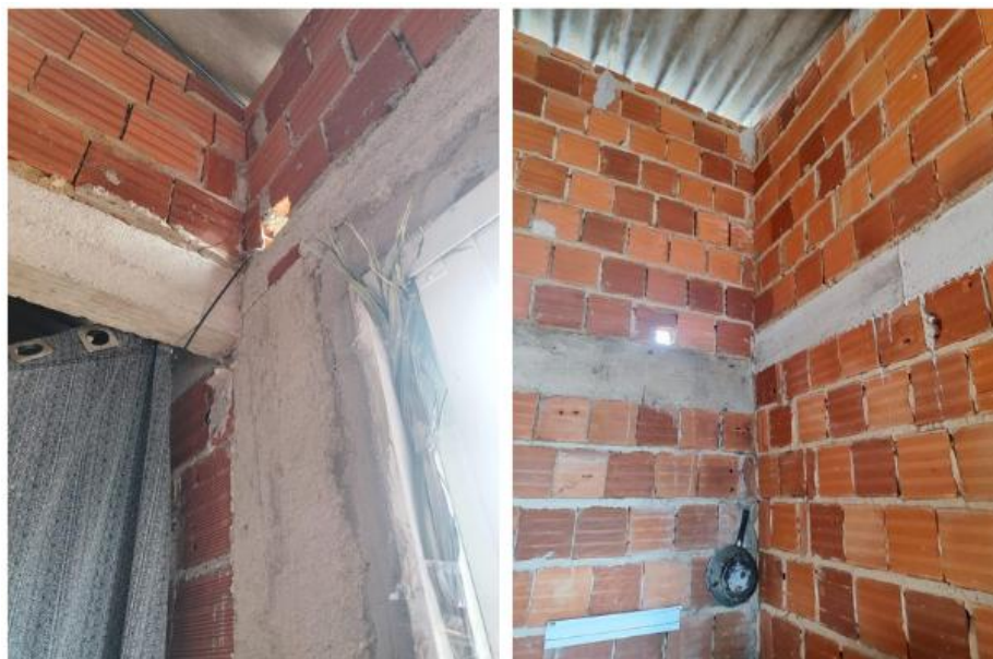
Figura 24 – Descontinuidade e desalinhamento entre elementos estruturais, com execução irregular de cintas de amarração e ausência de apoio adequado para vigas na ATMH-3
