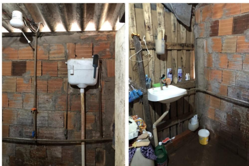
Figura 15 - Condições do banheiro em ATNH-1 Fonte: Acervo Projeto ATHOS (2024)
