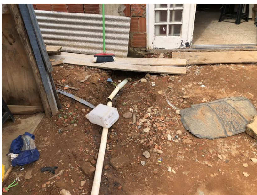
Figura 20 – Tubulação de esgoto com descarte de efluentes diretamente no quintal da residência. Fonte: Acervo Projeto ATHOS (2024)
