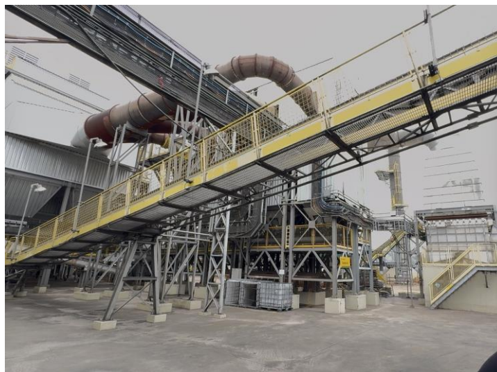
Figura 46. Vista de uma das caldeiras da Usina Termelétrica a biomassa
