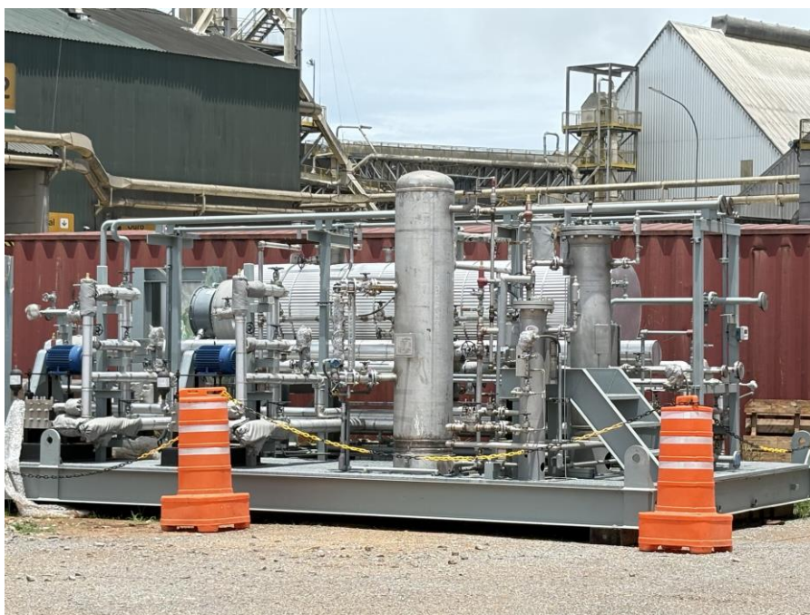
Figura 50. Equipamento de desidratação do gás, que faz parte do sistema BECCS em implantação
