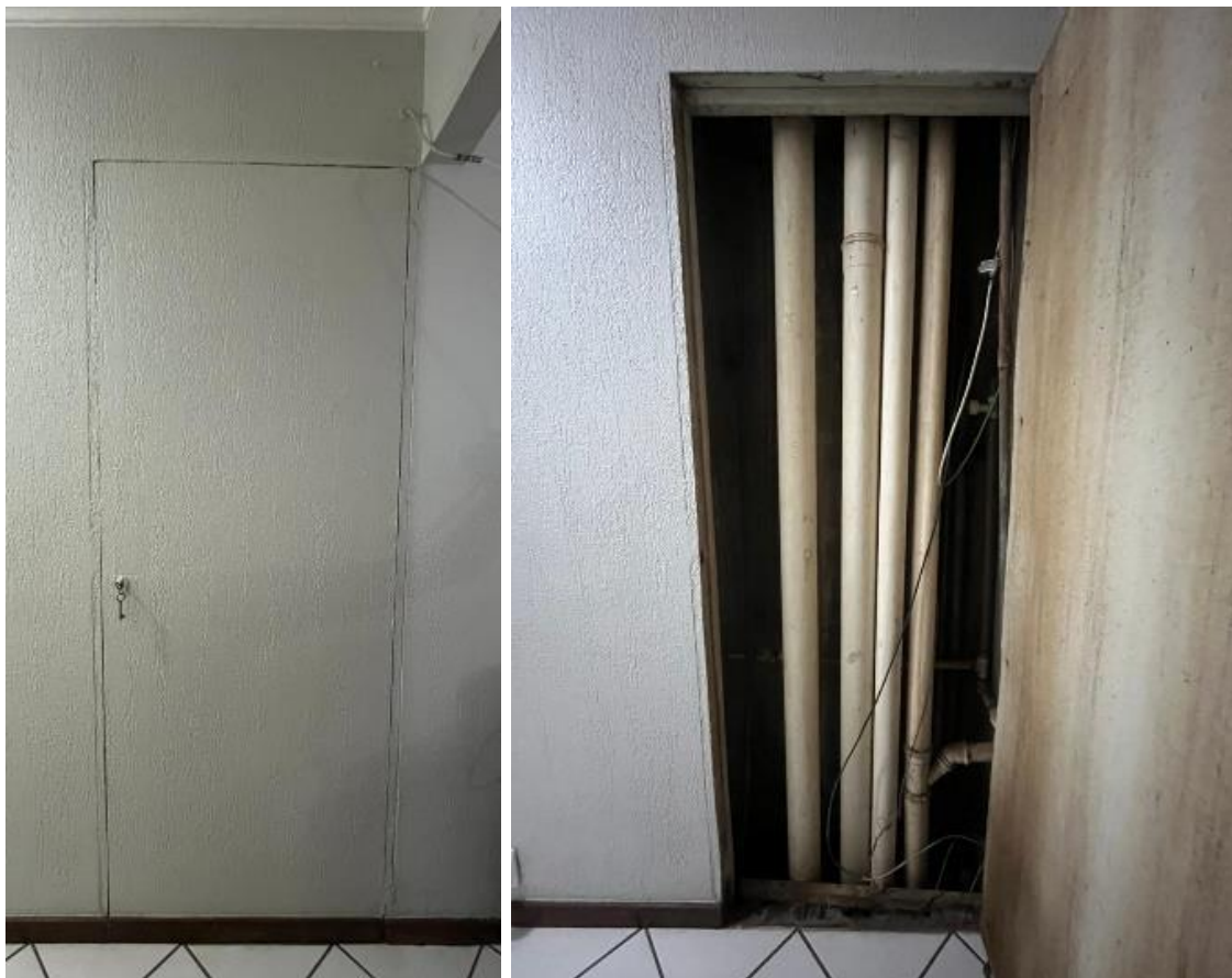
Figura 76 - Armário hidráulico com a porta aberta e fechada. Fonte: da autora.
