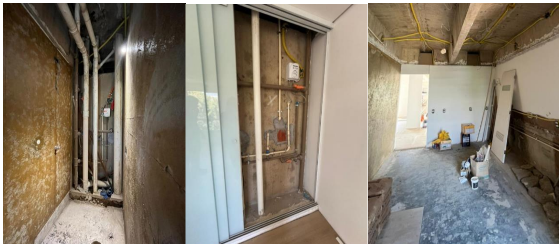
Figura 105 –À esquerda: Passagem das instalações pelo shaft do banheiro de serviço. No centro: Passagem das instalações no shaft no quarto. À direita: Passagem das instalações elétricas entre as vigas 203 . Fonte: da autora.
