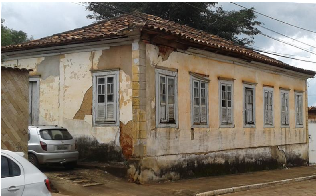
Figura 180 – Residência típica vernacular não conservada, Praça do Rosário
