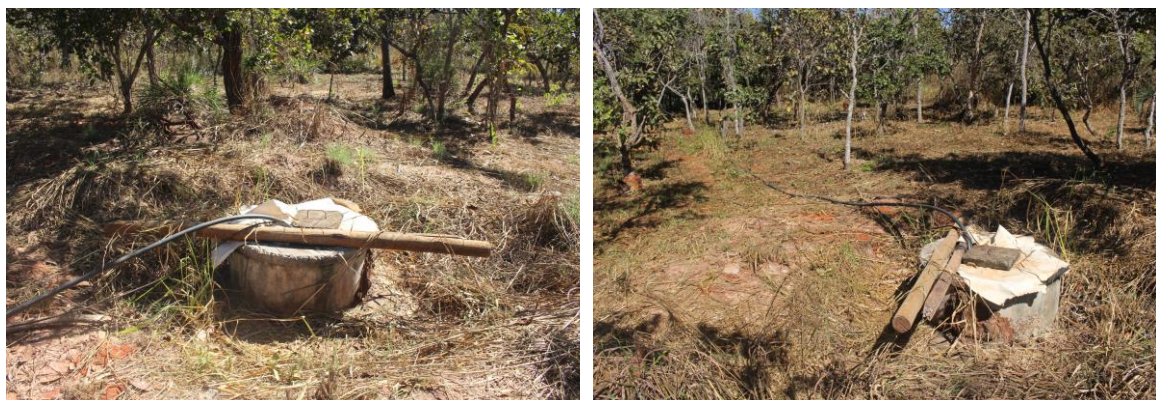
Figura 5.56 - Condições estruturais do poço no domicílio 1.
