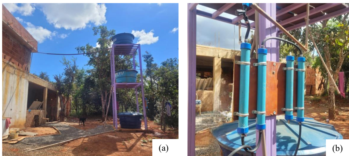
Figura 5.55 - (a) Visão geral do sistema de tratamento de água instalado pelos moradores do domicílio 4 (b) filtros de acrílico e filtro de carvão ativado.
