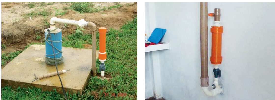
Figura 3.10 - Clorador simplificado instalado na saída do poço (a) e na subida para o reservatório (b).
