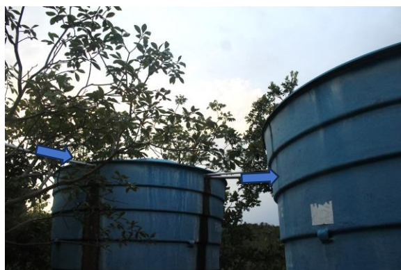
Figura 5.25 - Tubulações de alimentação e saída na caixa de decantação.
