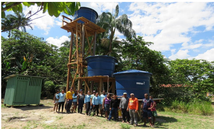
Figura 3.8 - Sistema instalado no Projeto Sanear Amazônia (FBB, 2015)
