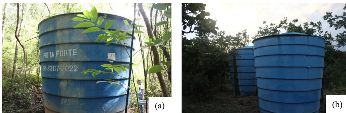
Figura 5.8 - Reservatórios de recepção (a), decantação e distribuição (b).
