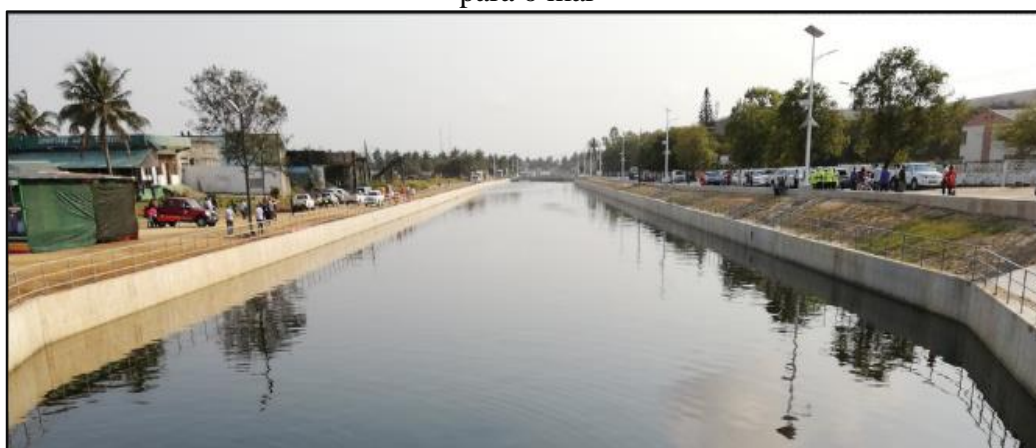
Figura 1 - Sistema de drenagem para escoar águas pluviais dos bairros do Município da Beira para o mar
