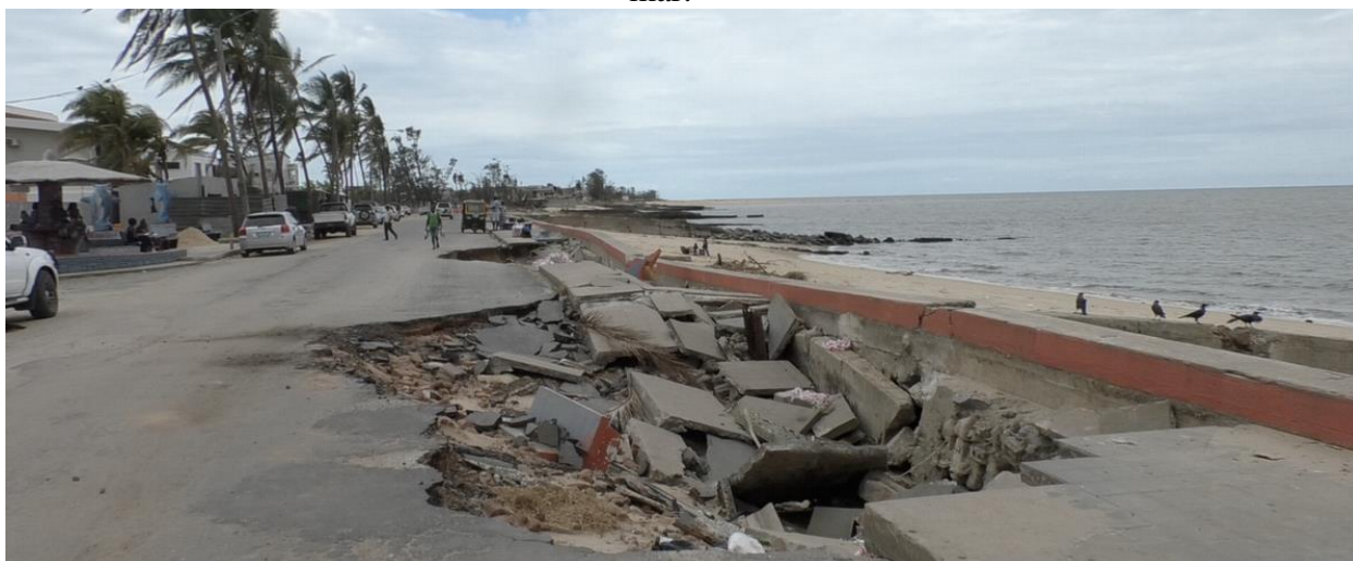
Figura 7 - Litoral do Município da Beira, parcialmente destruída pela invasão das águas do mar.
