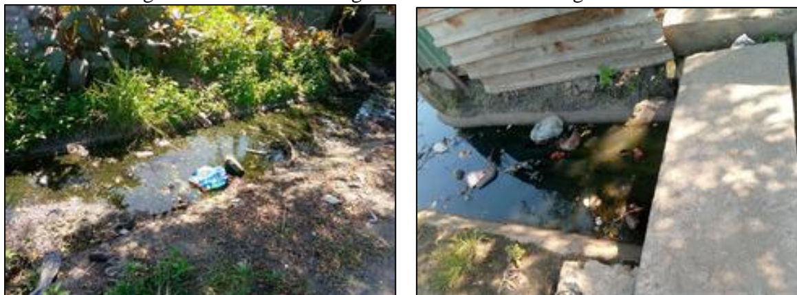
Figura 15 – Sistema de esgoto nos bairros de Nhangau e Munhava
