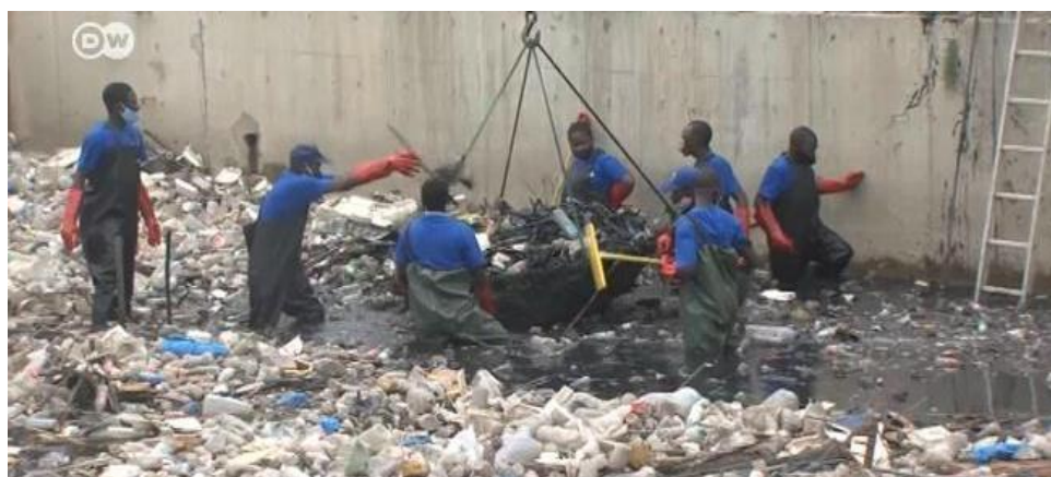
Figura 3 – Aspecto de grande volume de resíduos sólidos presente no sistema de drenagem e do trabalho para sua remoção, para garantir o escoamento das águas pluviais
