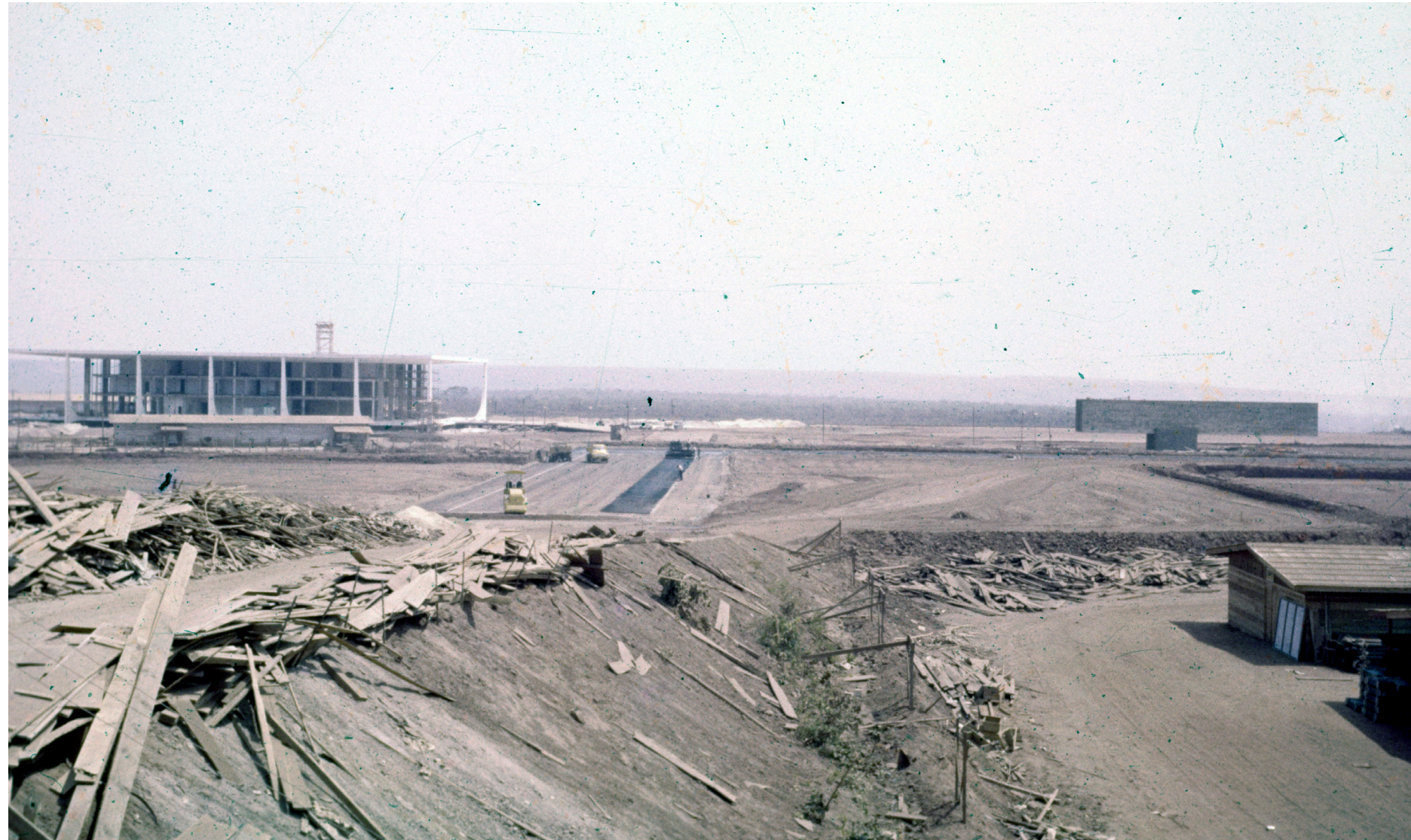
Vista da construção da Praça dos Três Poderes, Museu Histórico de Brasília e Palácio do Planalto. Autor: Não identificado [1958-1959]. Fonte: Fotografia do Fundo Novacap, sob a guarda do Arquivo Público do Distrito Federal.
