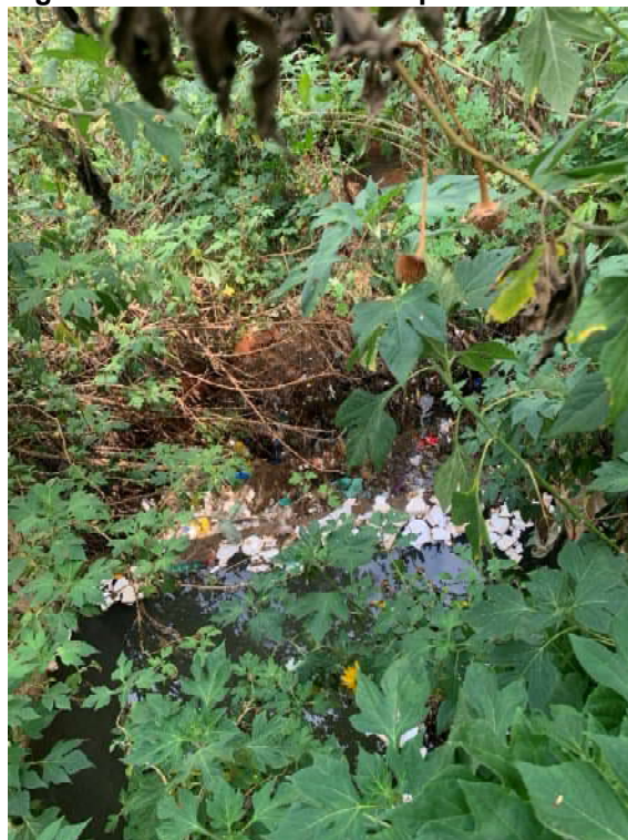
Figura 46 - Resíduos no dissipador de saída.
