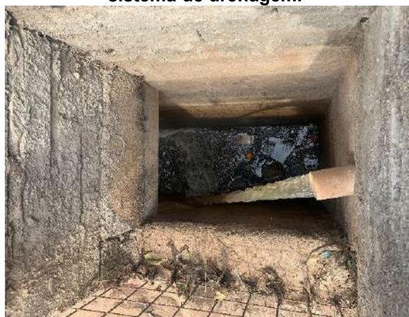
Figura 70 - Lançamento de efluente no sistema de drenagem.
