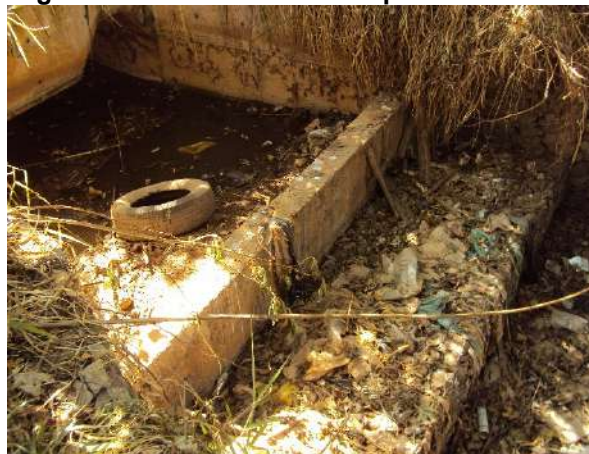
Figura 27 - Resíduos no dissipador de saída.
