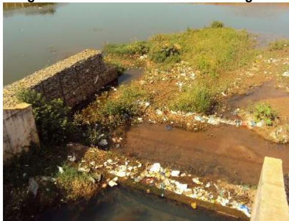
Figura 26 - Resíduos no interior da lagoa.
