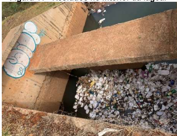
Figura 41 - Resíduos no interior da lagoa.
