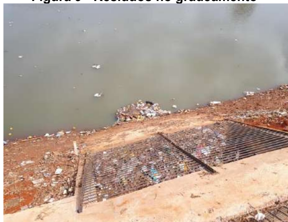
Figura 9 - Resíduos no gradeamento
