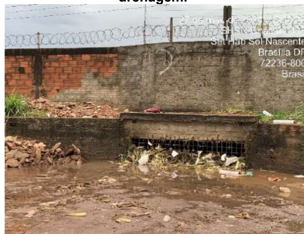
Figura 88 - Gradeamento entrada sistema de drenagem.
