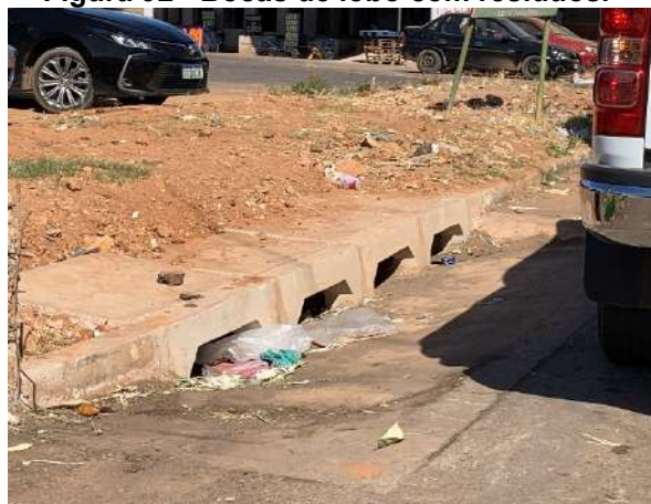
Figura 92 - Bocas de lobo com resíduos.
