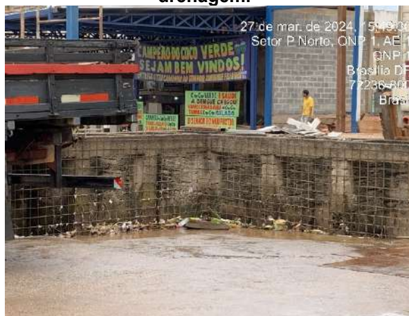
Figura 87 - Gradeamento entrada sistema de drenagem.
