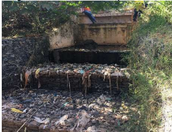
Figura 22 - Resíduos no dissipador/saída
