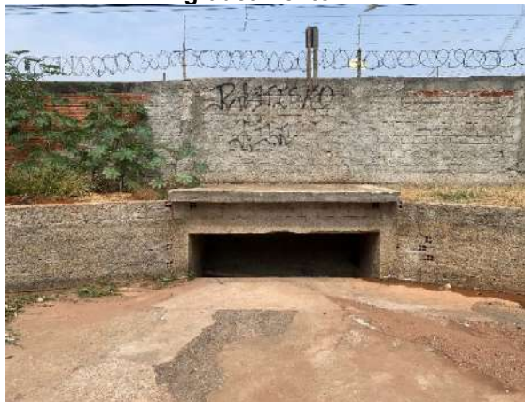
Figura 71 - Entrada sistema drenagem sem gradeamento.
