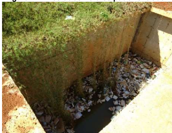
Figura 17 - Resíduos no dissipador/entrada.
