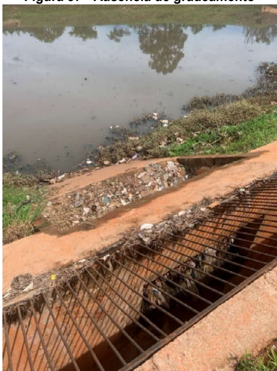
Figura 37 - Ausência de gradeamento
