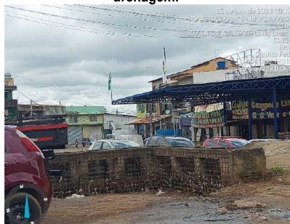
Figura 80 - Gradeamento entrada sistema de drenagem.
