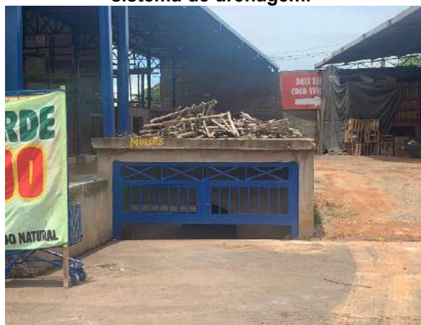
Figura 66 - Gradeamento parcial entrada sistema de drenagem.
