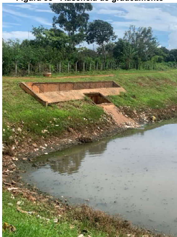
Figura 38 - Ausência de gradeamento
