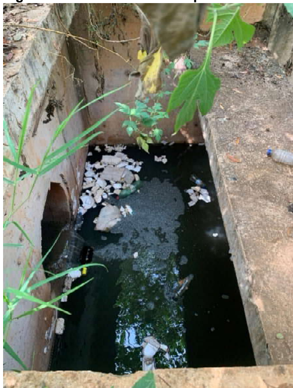
Figura 45 - Resíduos no dissipador de saída.
