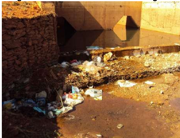
Figura 20 - Resíduos no interior da lagoa.
