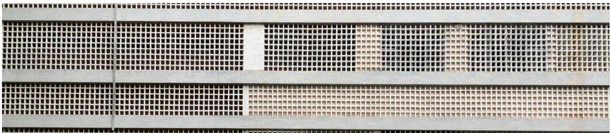
Figura 71. Detalhe da fachada posterior obstruída do Bloco C da SQS 308. Autoria própria, 2024.
