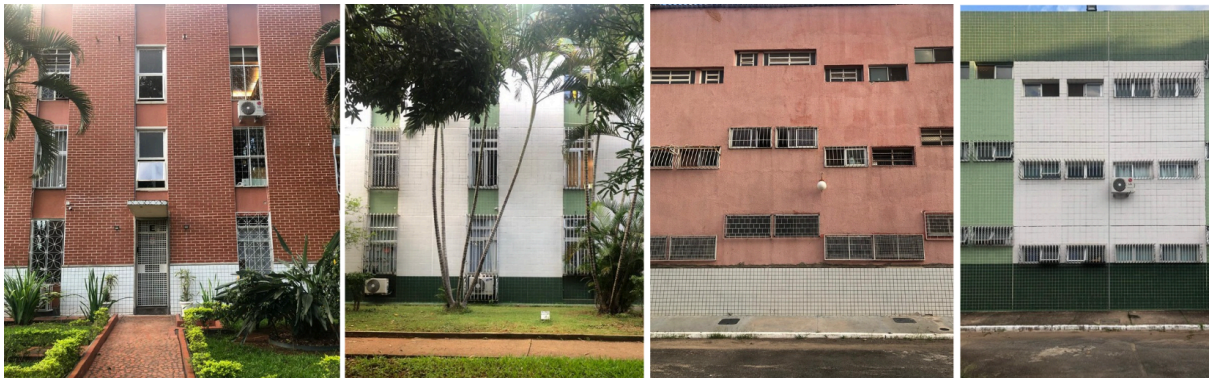
Figura 75. Detalhe da ausência de padronização nas alterações das fachadas dos blocos O e D, respectivamente, da SQS 411. Autoria própria, 2024.
