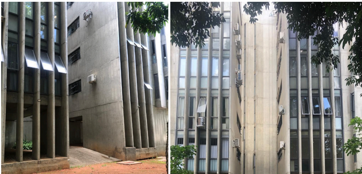
Figura 90. Detalhe da instalação de condensadoras nos recuos das fachadas laterais (leste e oeste) do Bloco I da SQN 107. Autoria própria, 2024.
