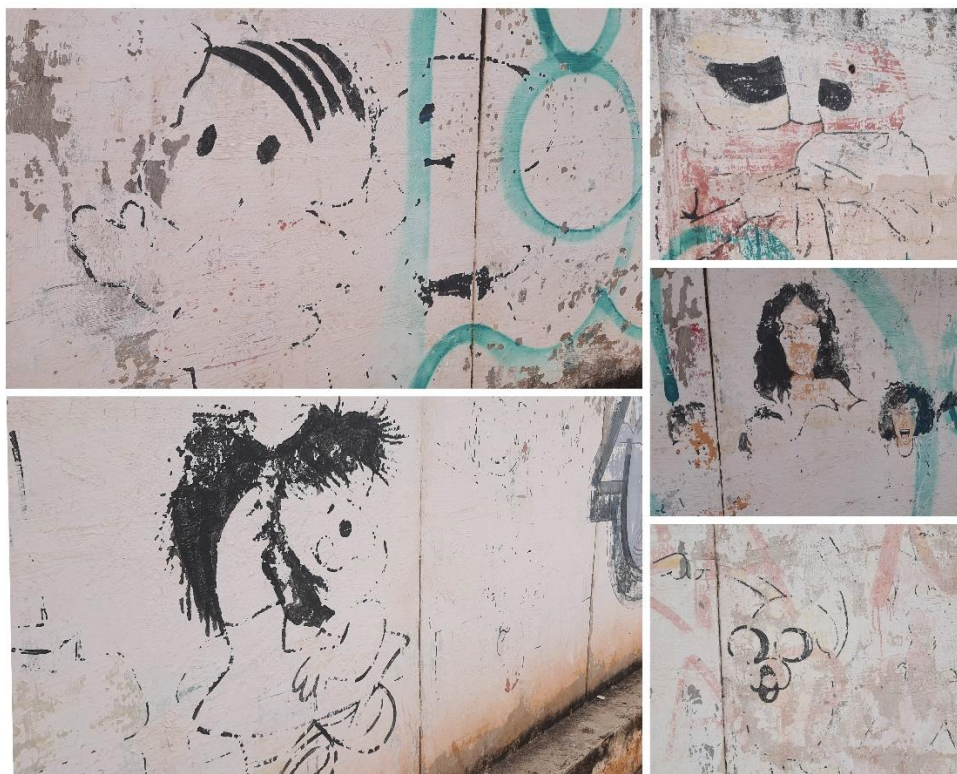
Figura 16: Pinturas desgastadas da mureta.
