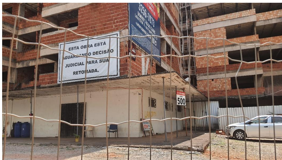
Figura 11: Lava-jato instalado na área externa do Res. Park Way e placa contendo aviso.
