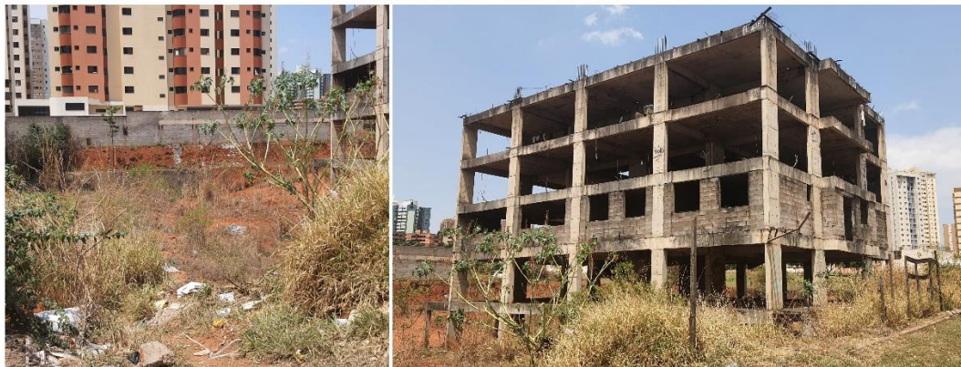
Figura 53: Prédio em ruínas na Av. Parque Águas Claras (Lote 75). Foto colhida em novembro de 2023.
