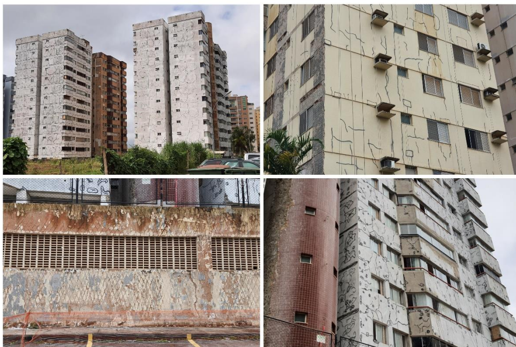
Figura 19: Prédios "tatuados" aguardando reforma. Fotos do Residencial Águas Claras II 29 (R. 4 Sul).
