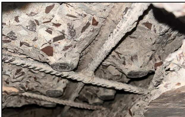
Figura 4.25 – Ruptura por arrancamento do cone de concreto na laje SS-1,2-0.
