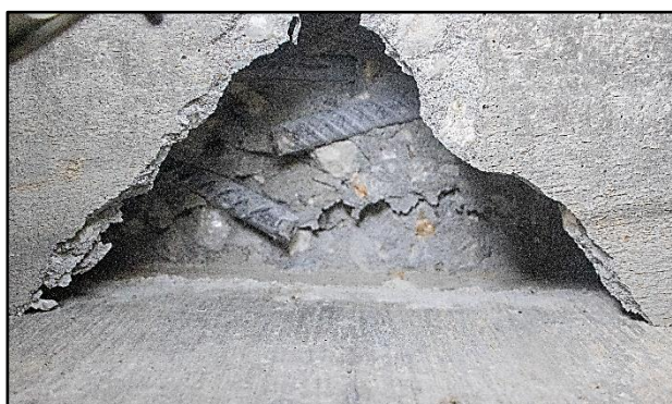
Figura 4.26 – Detalhe do estribo individual após a ruptura da laje.
